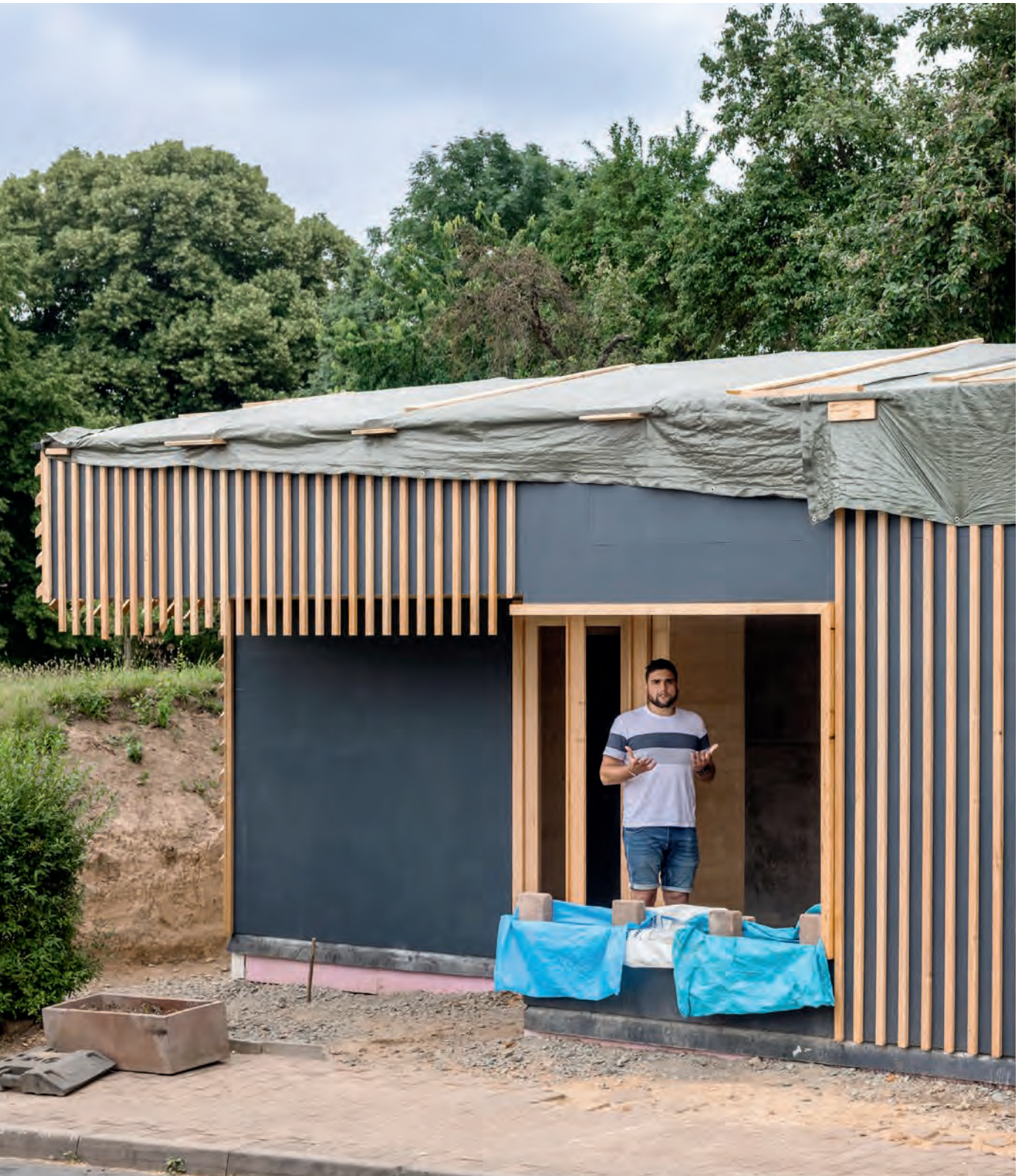
Christopher Kaufmann auf der Baustelle in Urleben im Juni 2022. Die vier geplanten Gesundheitskioske in Blankenburg, Bruchstedt, Kirchheilingen und Urleben wurden von PASEL-K Architects aus Berlin als individuelle Holzbauxperimente im Kleinformat entwickelt. Foto: Michael Reichel
